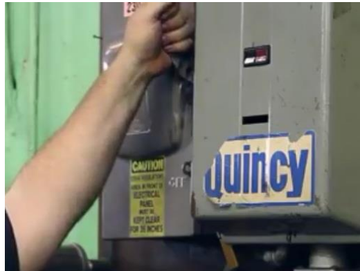
شكل رقم ٦٧: فصل مفتاح الكهرباء الرئيسي
